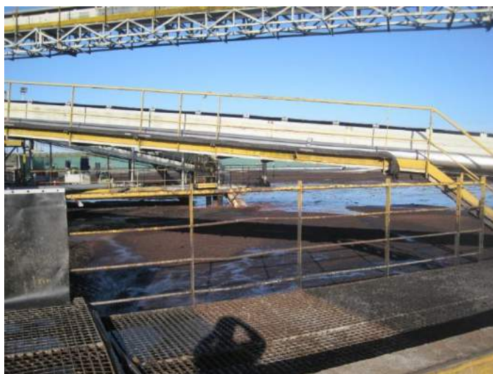
Figura 27 – Instalações da Central de Pata de Mulo
