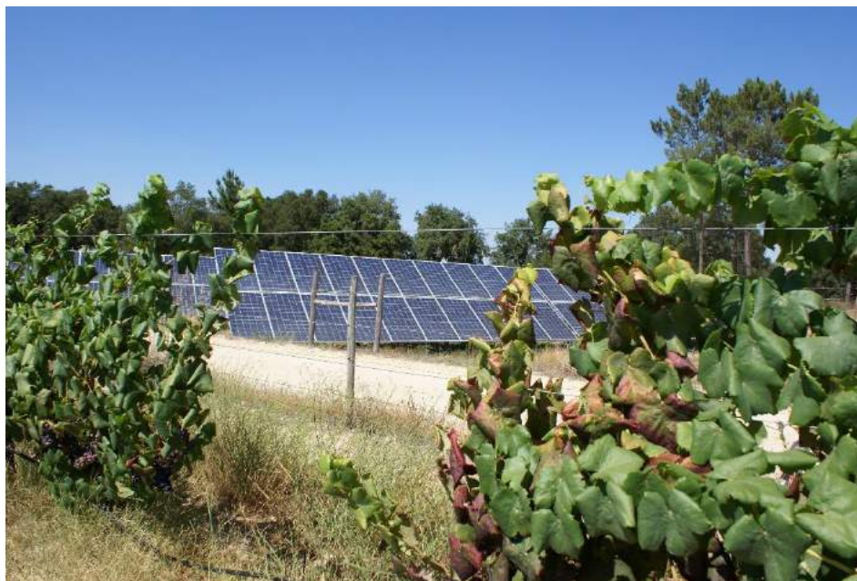
Figura 6 - Exemplo de instalação de um sistema de painéis fotovoltaicos numa vinha
